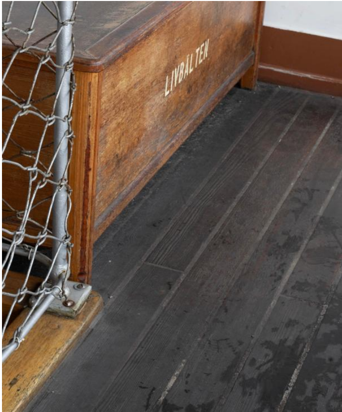
Foto från 2024 visande detalj från bryggdäck. Däcket, lagt 1994, är idag tjäroljat på samtliga utvändiga däcksytor och i huvudsak utfört med vit nåtning med modern nåtmassa av polymertyp.
