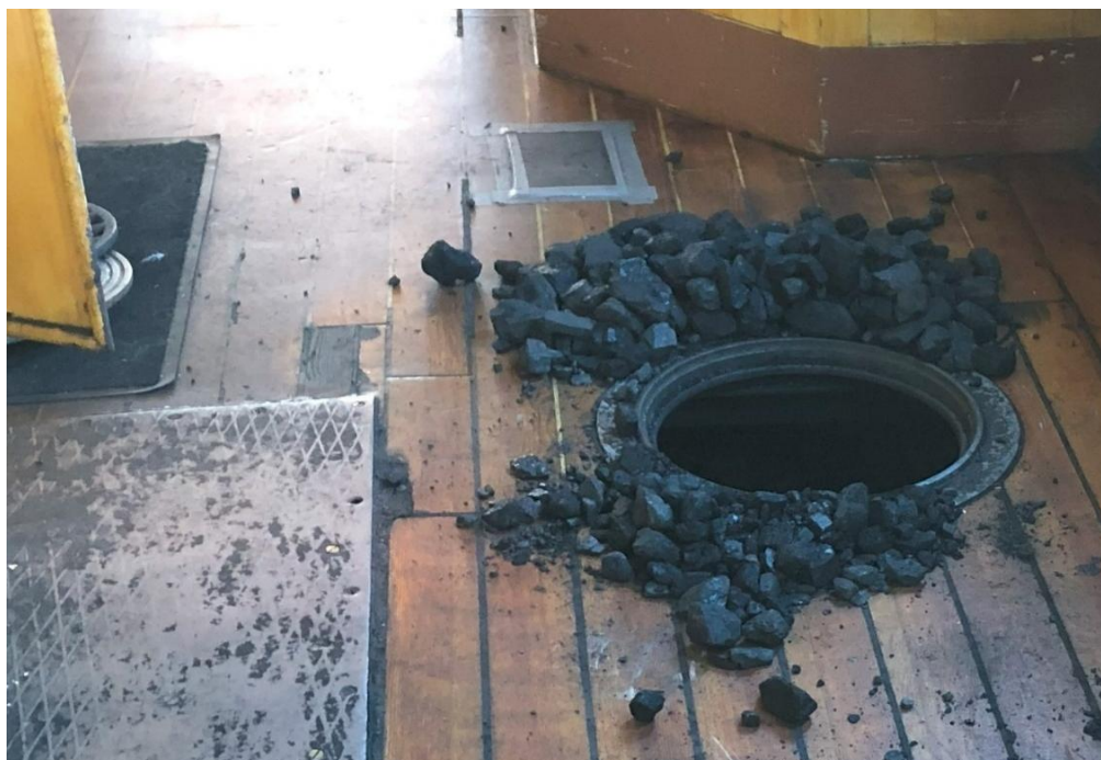
Foto från 2024 visande del av huvuddäck utanför maskinkappen. Däcksplanken är fernissade och nåtningen utgörs av en blandning av äldre, smalare, vita nåt och nyare, bredare nåt med svart modern nåtmasa. En skada har täckts över temporärt med ett fasttejp ark.
